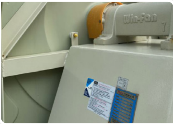
▲ 空污防制設備 --A004 洗滌塔
