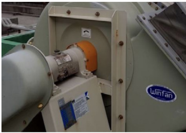
▲ 空污防制設備 --A001 洗滌塔
