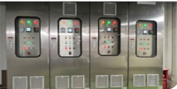
集塵機馬達安裝變頻器
