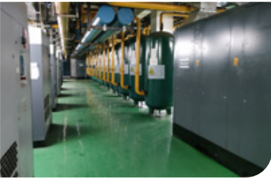
冰機汰舊更換高能效冰機
